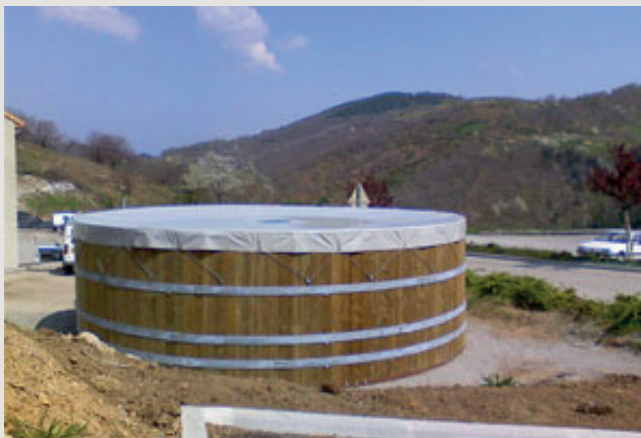
▲ Citerne en bois qui ne nécessite pas de soubassement en maçonnerie, ni d'autres installations annexes.
