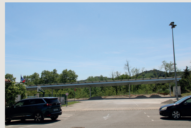
▲ Les ombrières photovoltaïques sur parking d'une place de village.
